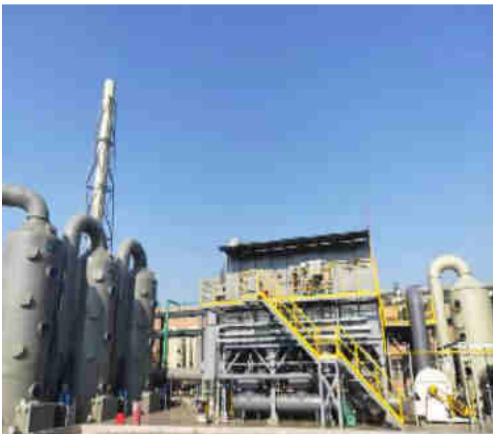
“RTO+三级吸收塔+生物滴滤除臭系统” 末端废气处理设施
